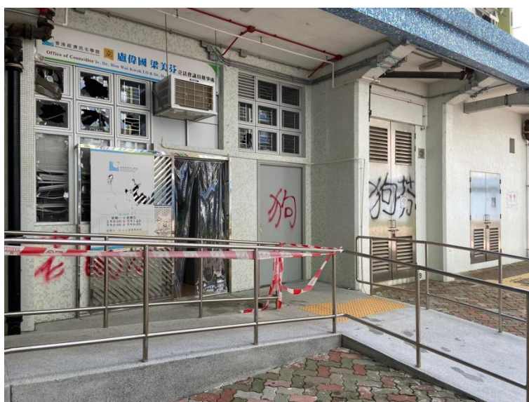
10月6日，暴徒毀壞經民聯元州邨辦事處冷氣機及窗戶，並用消防喉向辦事處灌水，致所有電腦報廢，文件全濕。
